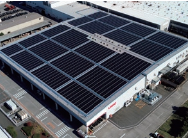
佐倉工場太陽光発電設備
