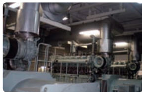
自家発電設備(いわき工場)
