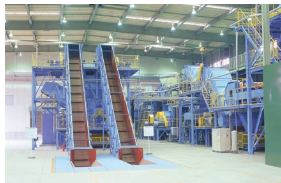
RPF (Refuse Paper & Plastic Fuel) 製造設備
