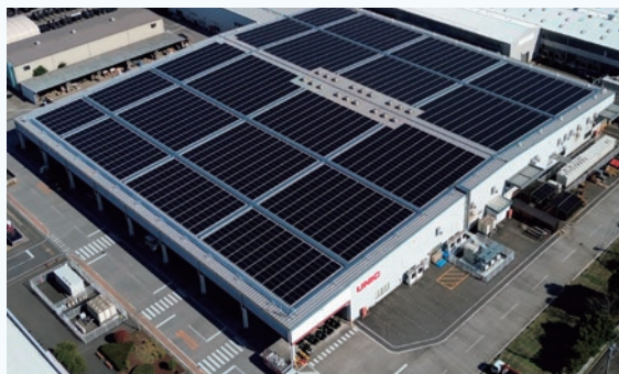
佐倉工場太陽光発電設備
