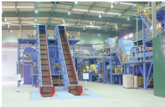
RPF(Refuse Paper & Plastic Fuel)製造設備
