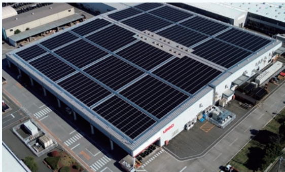
佐倉工場太陽光発電設備
