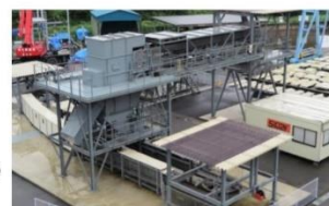
小山工場に設置した実機見学設備
