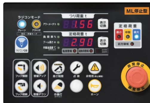
新型 集中コントロールパネル （クレーン本体両側）
