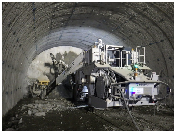
遠隔技術を活用した ICT 施工を実現するトンネルドリルジャンボ
